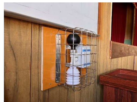
体育館に設置した熱中症センサー
